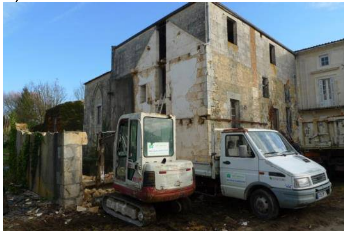
Figure 1 : Partie du moulin occupée par les Murin à oreilles échancrées démolie lors des travaux de rénovation (2015).
