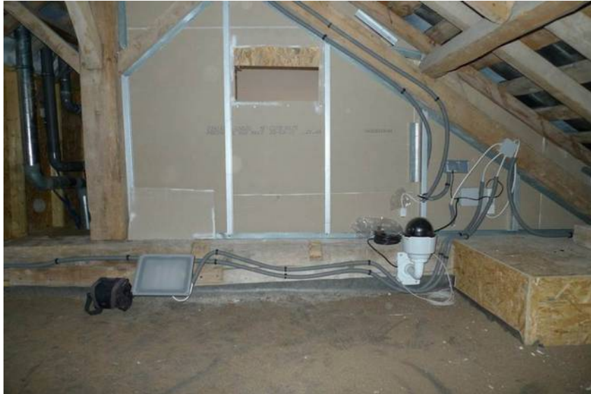
Figure 8 : Caméra 1 située dans le plus grand volume des combles et alimentée par 4 projecteurs infrarouge.
