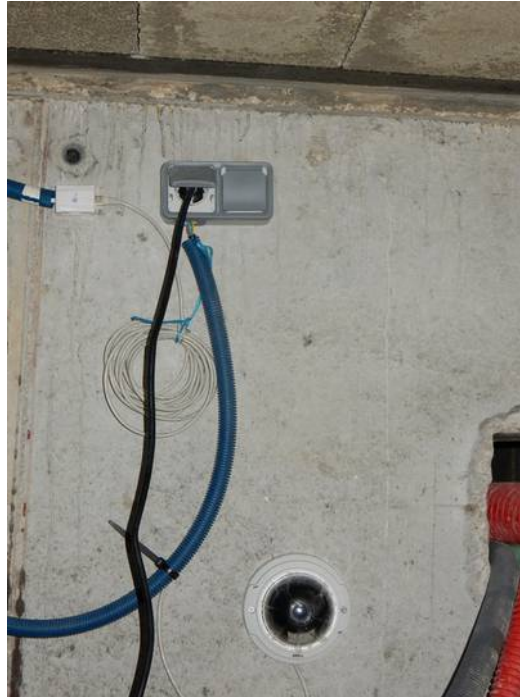
Figure 10 : Caméra 3 située au sous-sol et alimentée par 2 projecteurs infrarouge.
